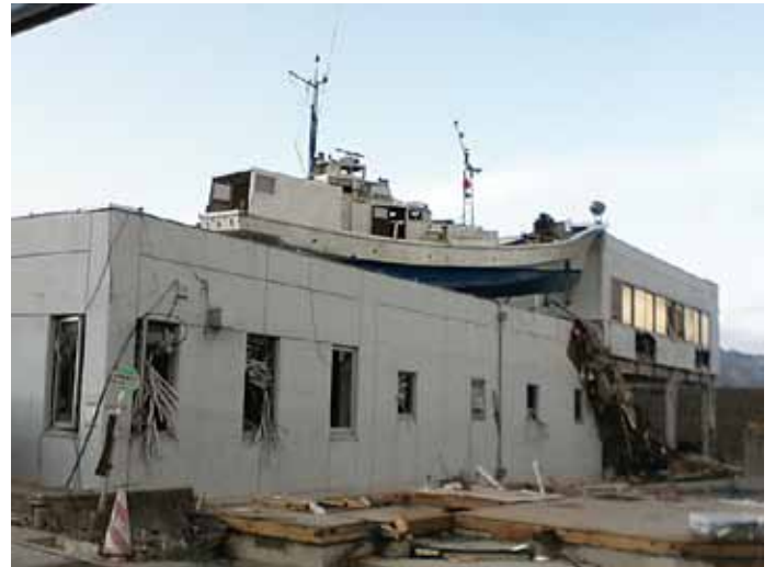
津波で打ち上げられたままの船
